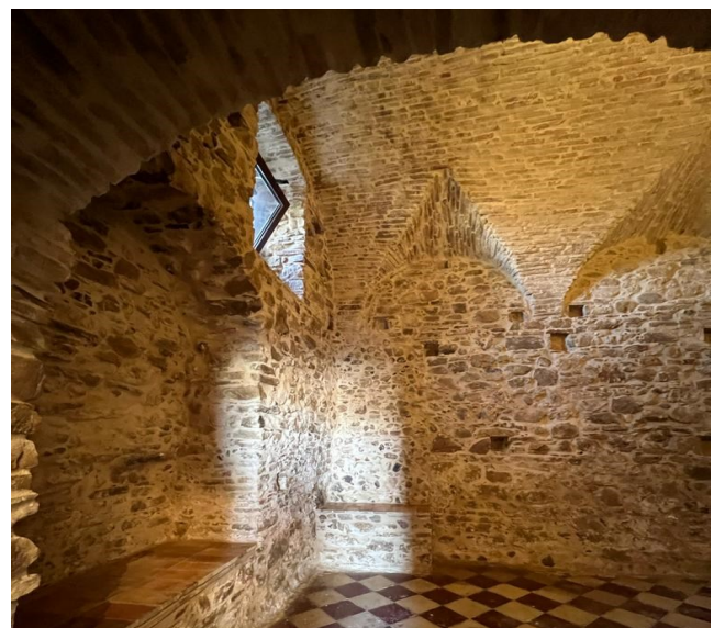
Forniamo un aggiornamento sui lavori di restauro della Cappella della Madonna della Stella a Craco a pagina 5.
